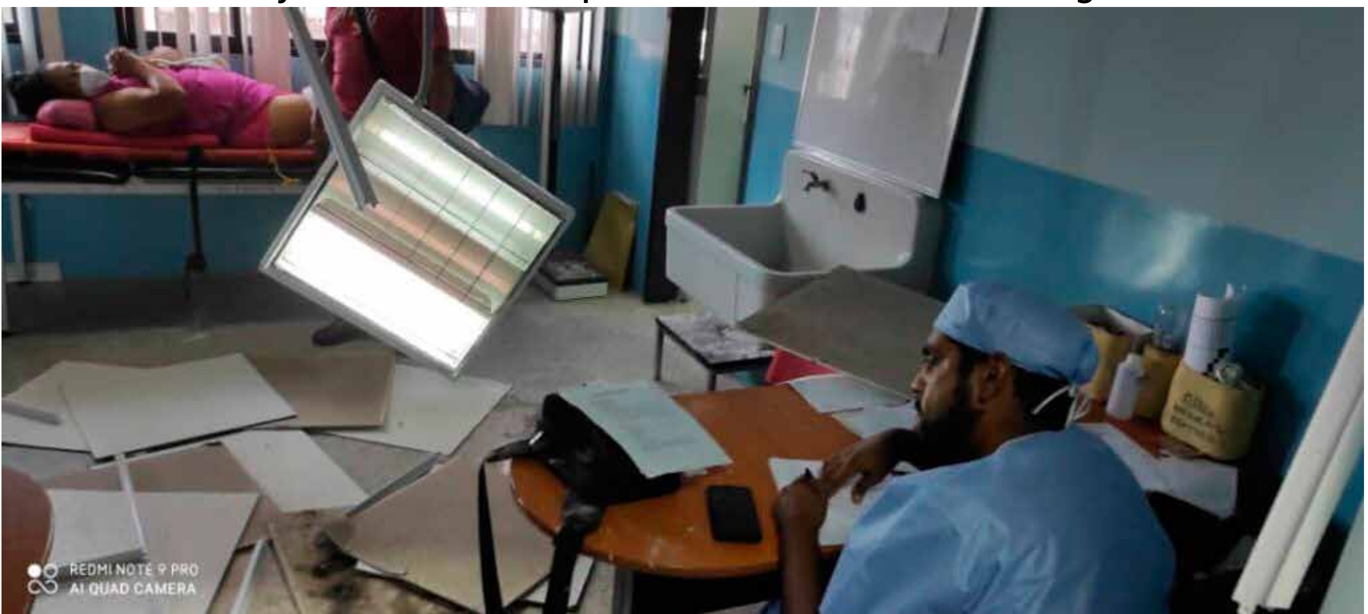
Trabajadores señalan que el área había sido rehabilitada recientemente.
